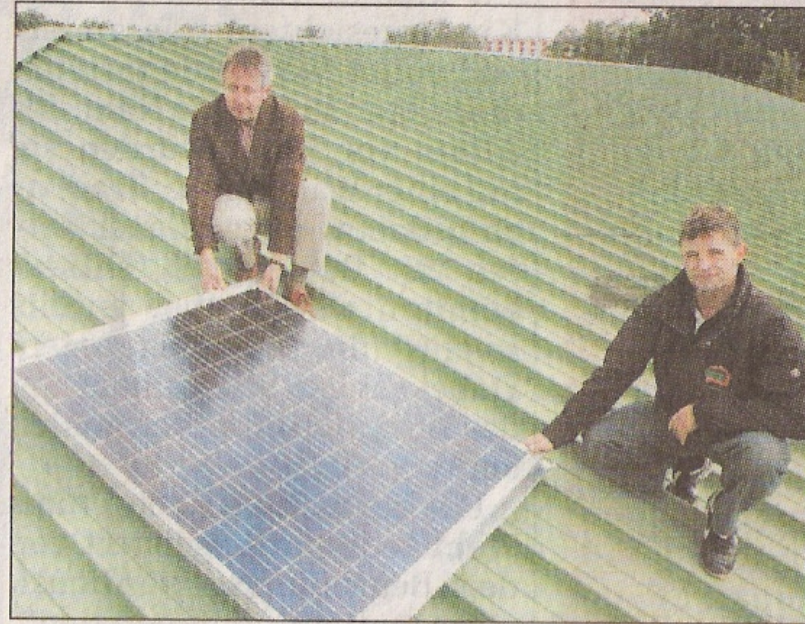
Thomas Falck (links) gehört zu 16 privaten Investoren, die sich am Bürgersolarkraftwerk auf den Dächern des WZV beteiligen. Andreas Brzoza von der Firma NDB bringt die Module bis Oktober an. Foto ger
